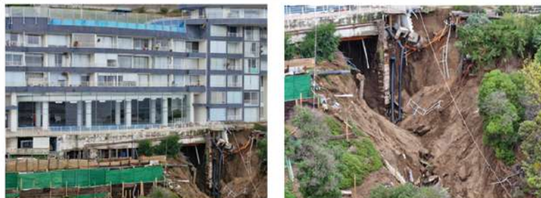
Imágenes de vistas aéreas de remoción en masa de fecha 11 de septiembre del año 2023, colindante al edificio Euromarina II.
